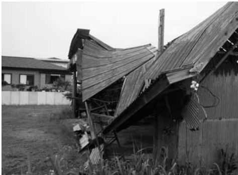
すでに倒壊している危険家屋
