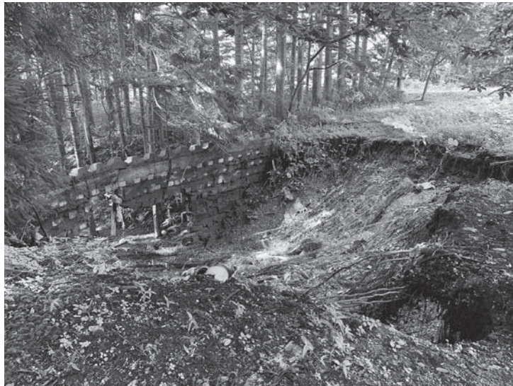
被災した泉沢地区二乃岱線泉沢駅背後地（土留崩壊）
