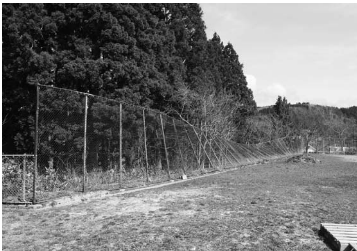
雪の重みで倒れ撤去されるフェンス (中学校グラウンド)
